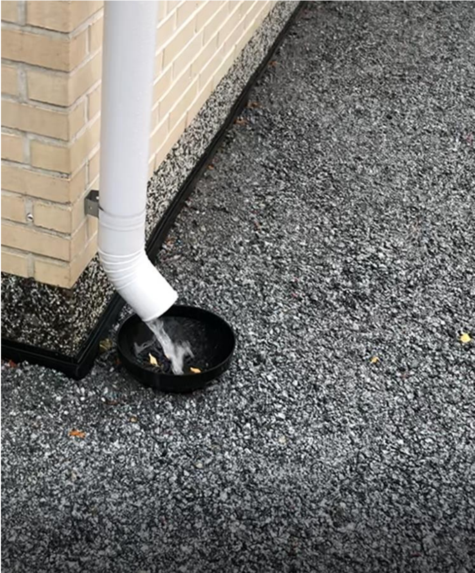
8. Tontin A sadevesikaivo
