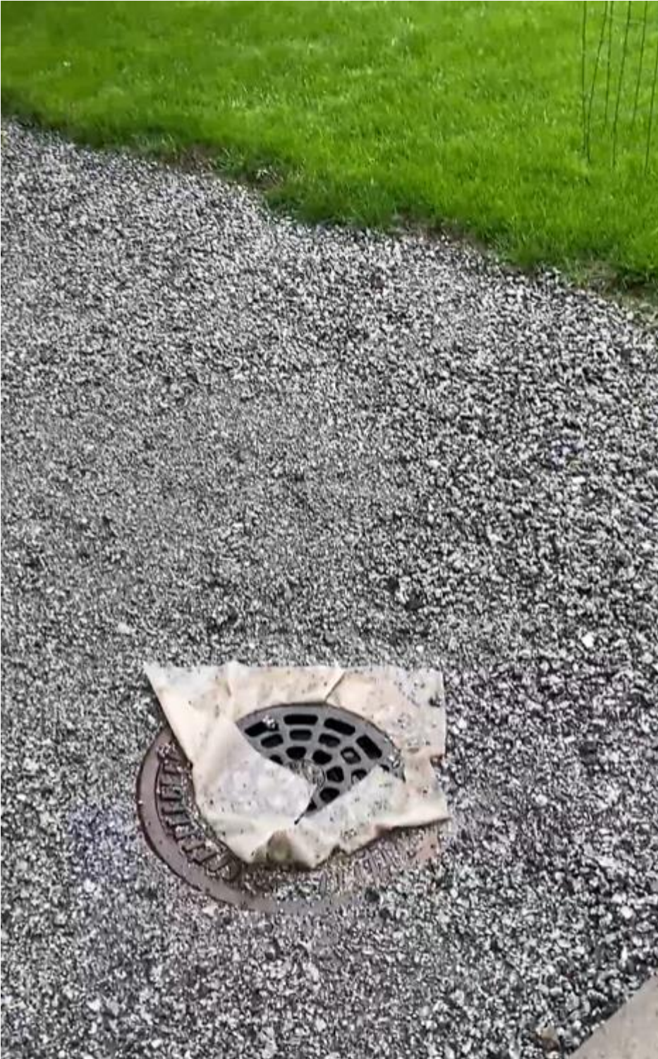
7. Tontin A pihan sadevesikaivo.
