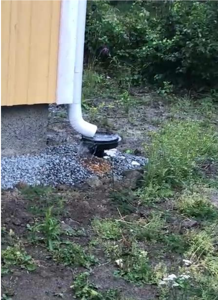
11. Tontin 1 B kattovedet roiskuvat suoraan rakennuksen vierustalle maahan.
