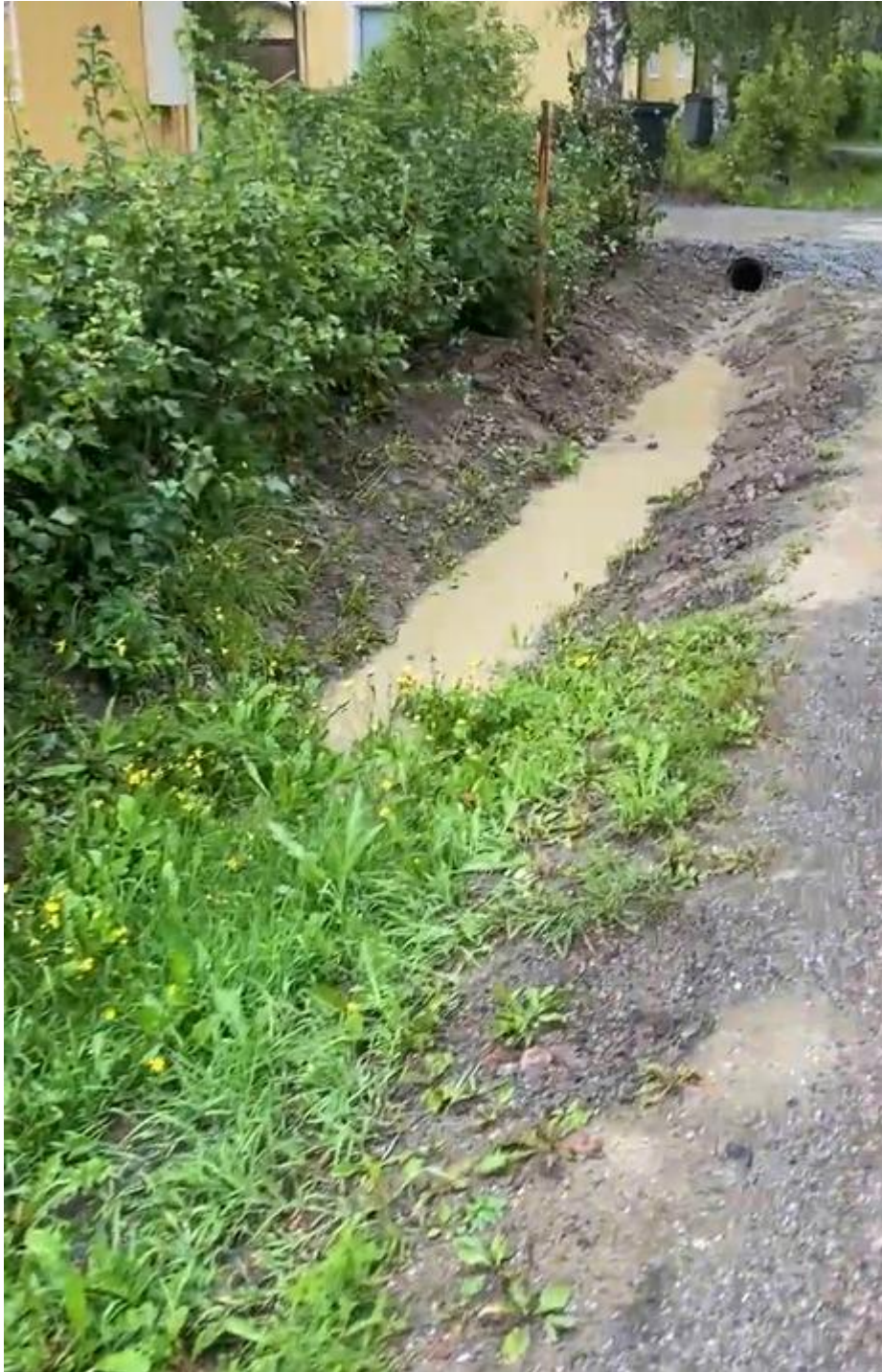
12. Tonttien viereisen katuojan rumpu ei vedä tontin 1 B tekemien kaivuutöiden jälkeen. Vesi seisoo ojassa.
